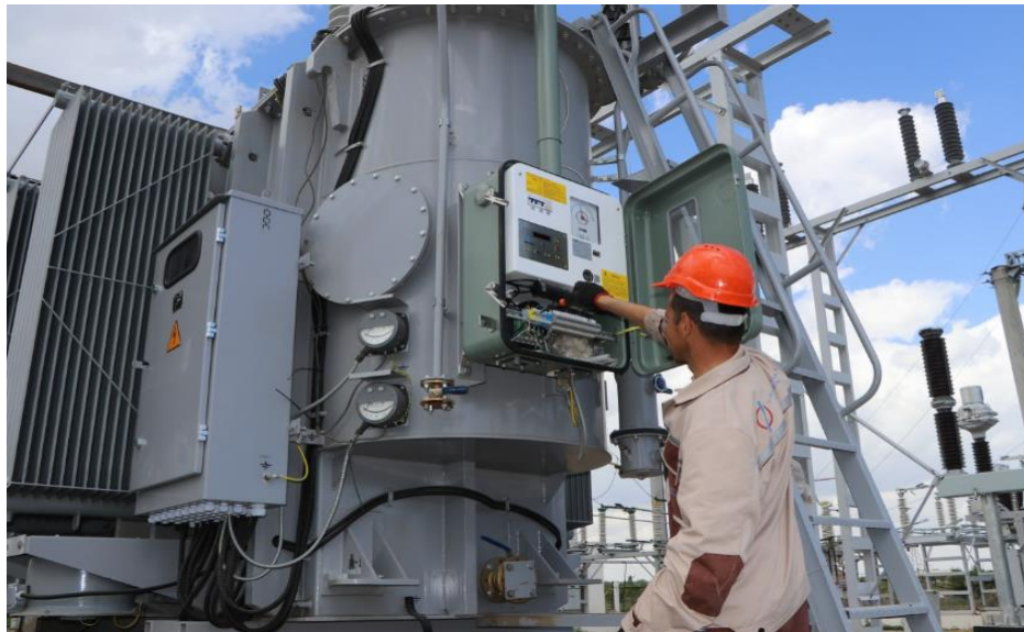
1.2-rasm. Elektr uzatish tizimida transformator uskunalarini profilaktik tekshirish va monitoring qilish
